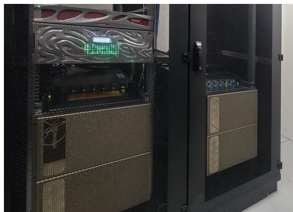
Rysunek 5.1. Klastr Eden M w serwerowni Wydziału MiNI PW po instalacji w roku 2021
